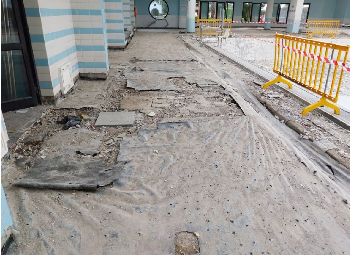
Instalaciones enterradas en playa de piscina. Impermeabilización inexistente
