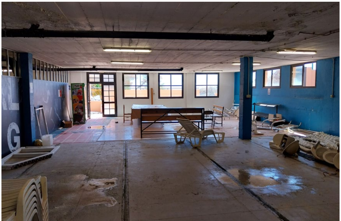
Filtración de agua en gimnasio sótano bajo solarium exterior.
