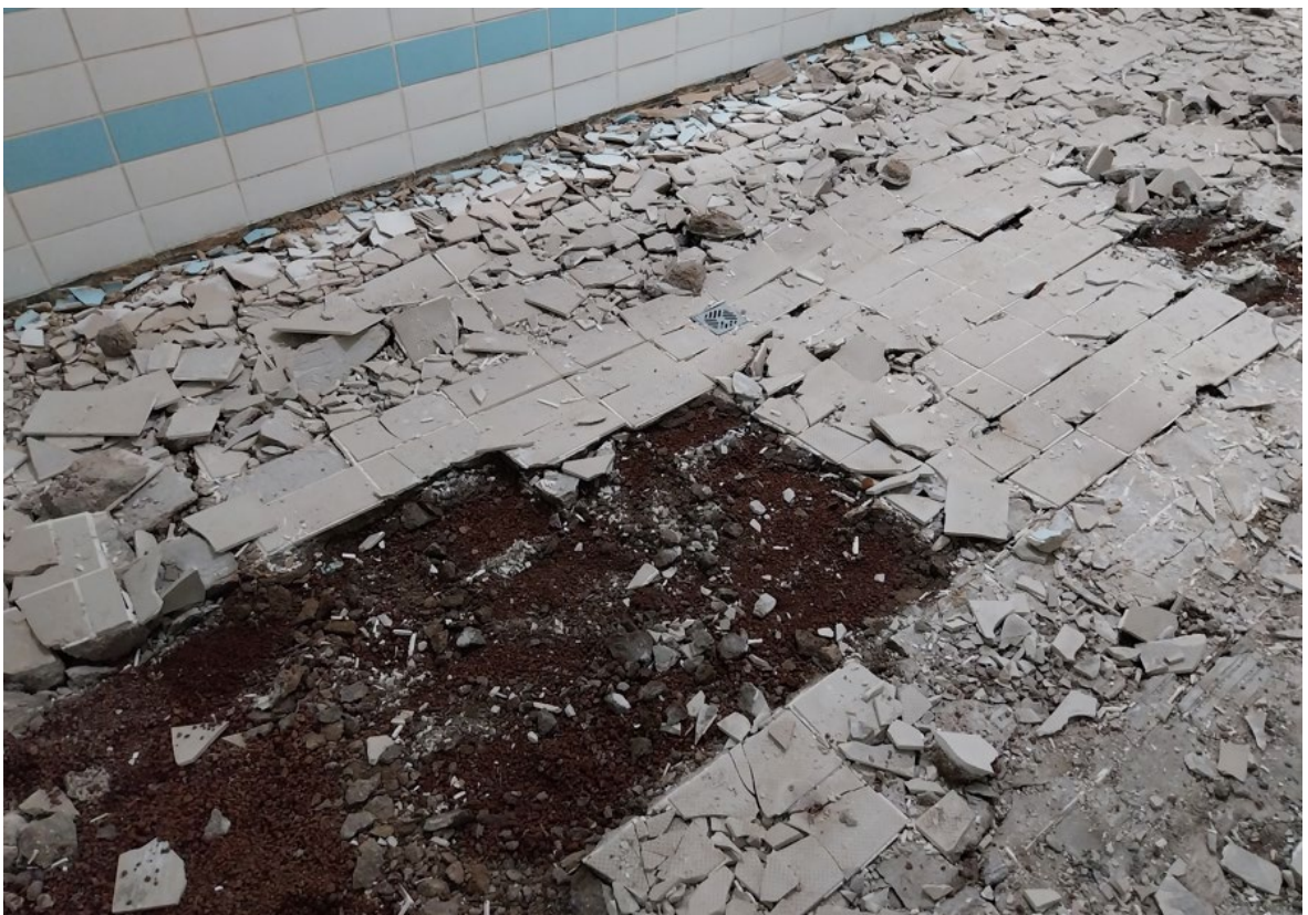
Piso de vestuarios sin solera debajo ni impermeabilización en duchas
