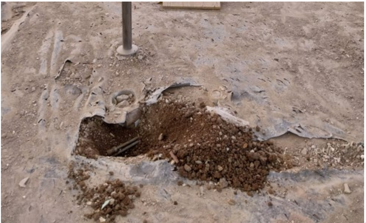
Instalaciones enterradas en playa de piscina. Impermeabilización inexistente
